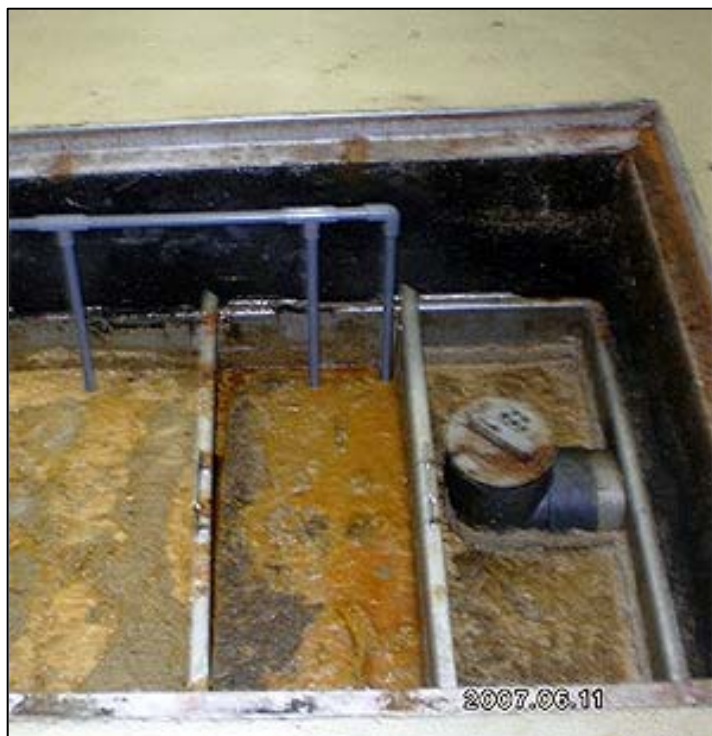
(上)オゾン分解装置稼働前 (下)一週間稼働後
